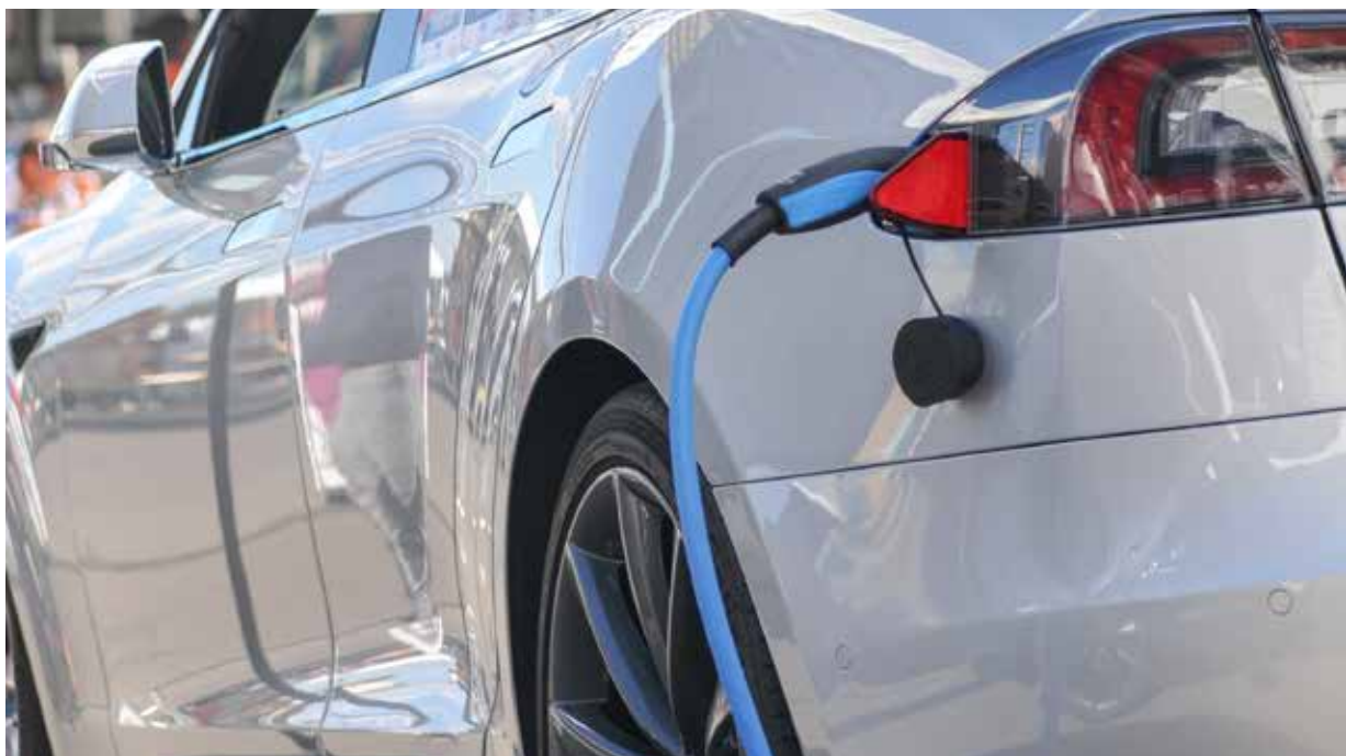
STROMTANKSTELLE FÜR ELEKTRISCH BETRIEBENE FAHRZEUGE (E-AUTO – E-BIKE – E-ROLLER)
